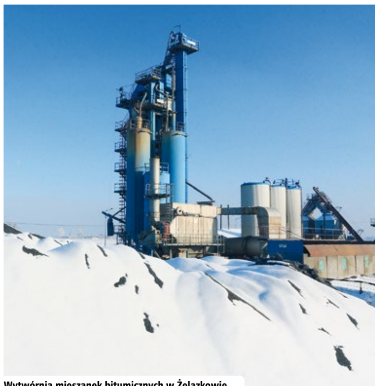
Wytwórnia mieszanek bitumicznych w Żelazkowie
